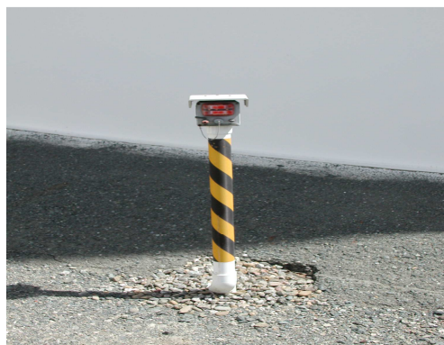
Modulo di monitoraggio allarmi perdite TT-FLASHER in un impianto serbatoi di stoccaggio in Brisbane CA.
