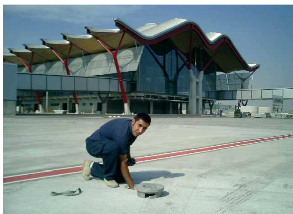
L'ispezione del cavo sensibile TT5000 può essere fatta dai punti di accesso in qualsiasi sezione dei 20km del Sistema di Rilevamento Perdite TraceTek installato nell'aeroporto di Madrid.
